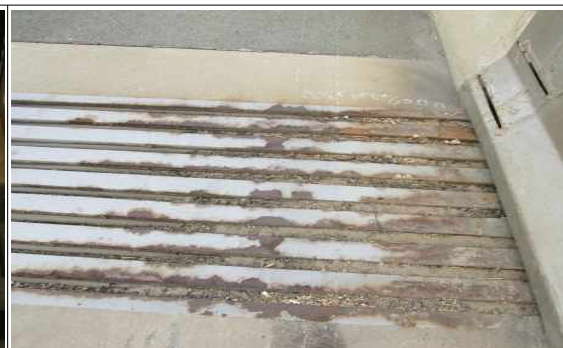
상행선 A2 신축이음 본체 녹발생 및 이물질 퇴적
