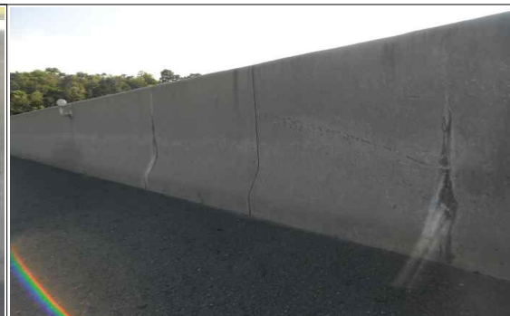
하행선 S3 방호벽 균열부 백태
