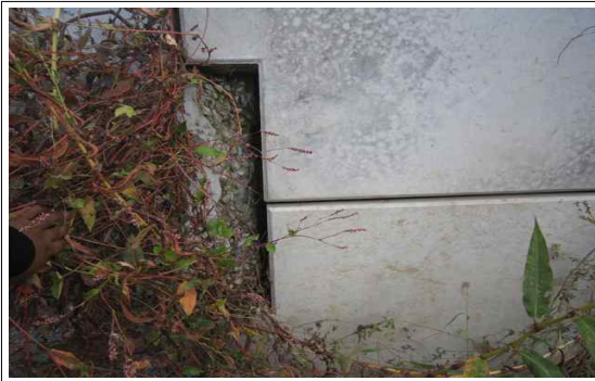
보강토 조립식 옹벽 S4 판넬 파손
