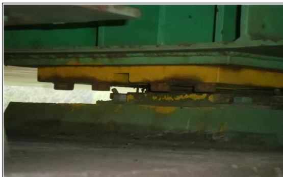
하행선 P8 SH5 Plate 도장손상 및 녹발생
