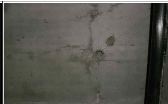
하행선 S11 주형내부 상면 콘크리트 박락
