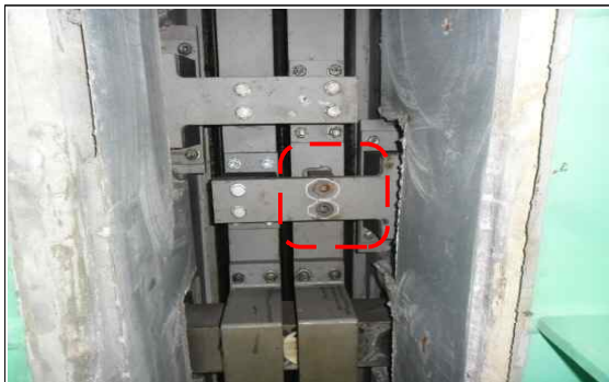
하행선 P4 신축이음 간격조절재 고정볼트 탈락
