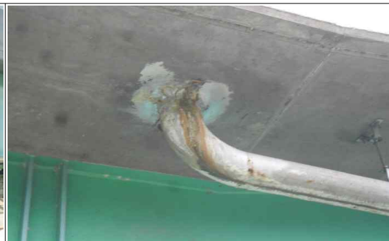
하행선 S1 배수관 바닥판 연결부 누수 (보수부 재손상)
