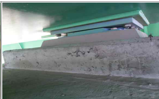
하행선 P10 SH2 받침콘크리트 재료분리
