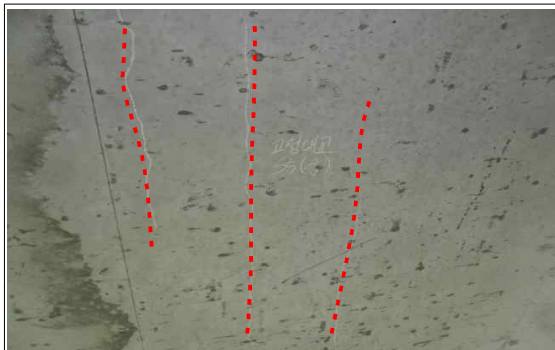
상행선 S5 주형외부 하부 슬래브 종방향 균열 (폭0.2mm)
