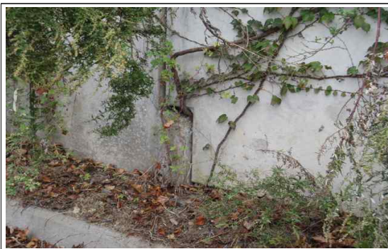
보강토 조립식 옹벽 S11 판넬 파손
