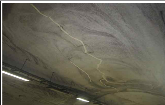
상행선 천정부 S41 재균열 (폭 0.3mm)
