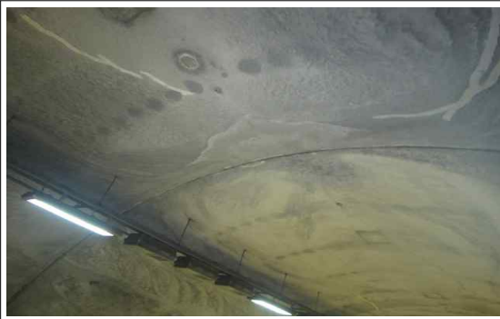
상행선 천정부 J23 콘크리트 들뜸 (A=0.1X0.2)
