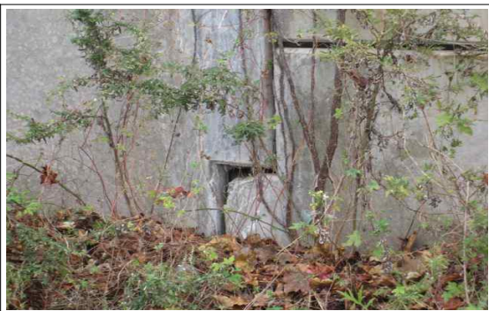
보강토 조립식 옹벽 S12 판넬 파손
