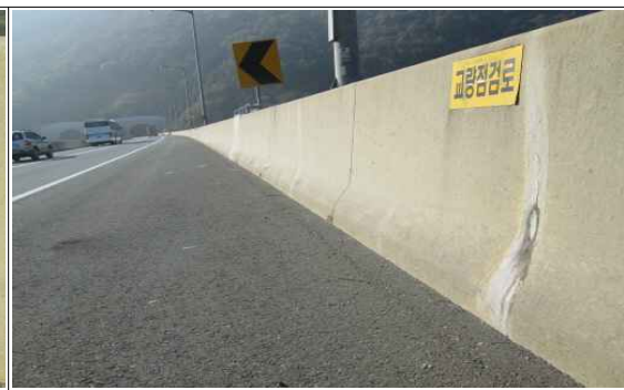
하행선 S4 방호벽 보수부 균열 및 백태
