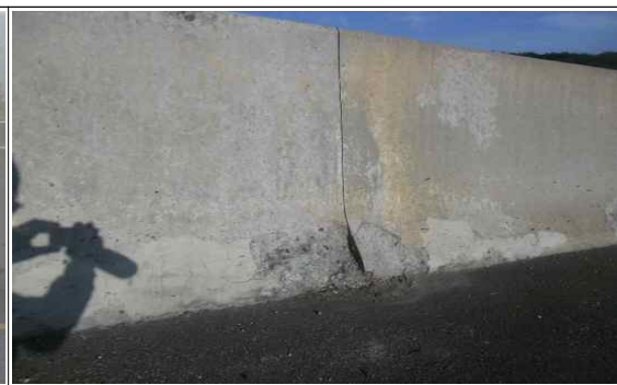
상행선 S12 방호벽 보수부 들뜸 및 파손
