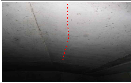
상행선 S12 주형내부 상면 종방향 균열 (폭0.2mm)
