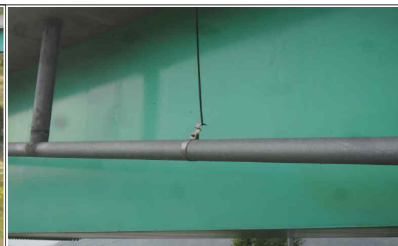
하행선 S12 배수관 체결 너트 탈락
