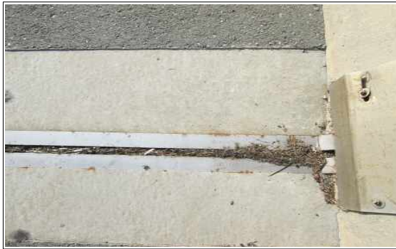
하행선 P3 신축이음 본체 이물질 퇴적
