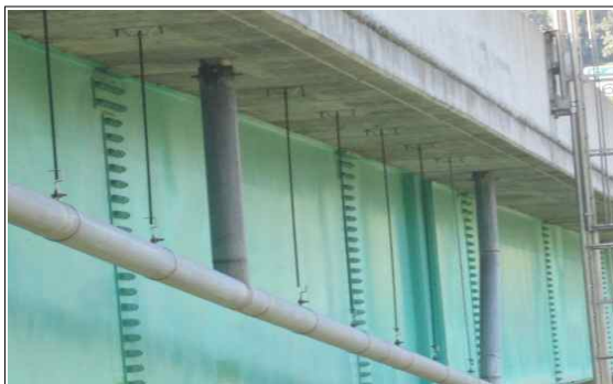
상행선 S1 배수관 연결고리 탈락
