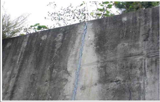
콘크리트 옹벽 J4 실란트 파손
