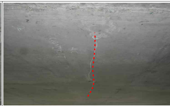
상행선 S4 주형외부 하부슬래브 종방향 균열 (폭0.1mm)
