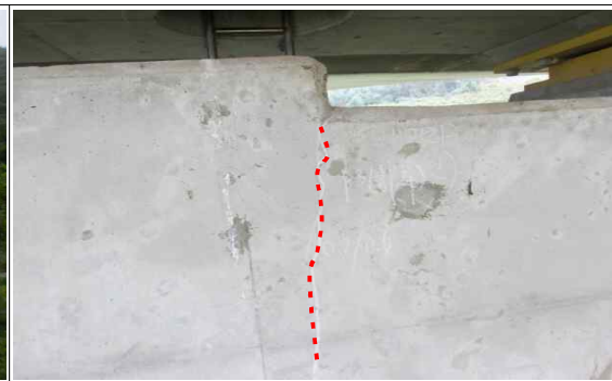
하행선 P3 코핑 배면 균열 (폭0.2mm)
