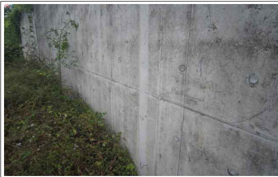
콘크리트 옹벽 S5 재균열 (폭 0.1mm)
