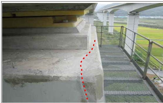
하행선 P3 코핑 상면 균열 (폭0.2mm)
