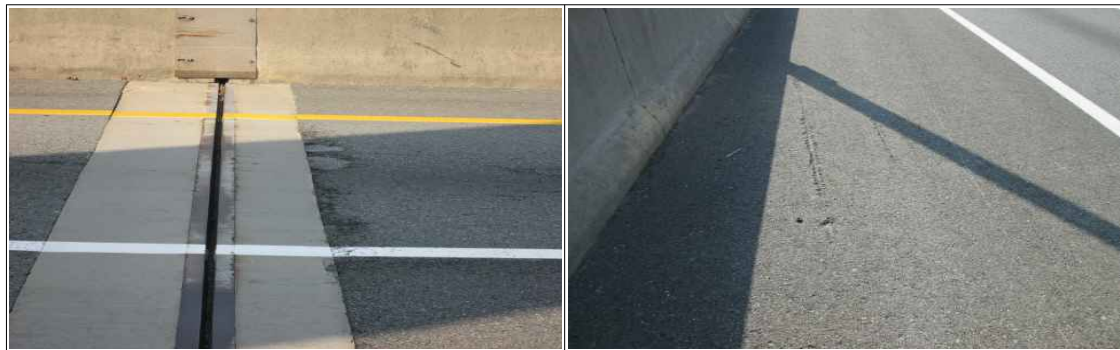
상행선 S1 (A1측) 교면포장 패임
