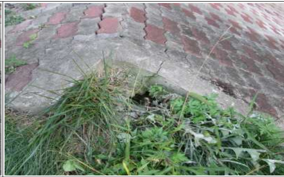
상행선 A1 법면 침하 및 공동 발생
