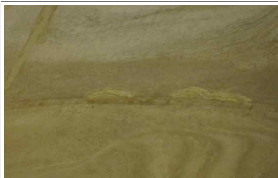
상행선 천정부 J24 콘크리트 들뜸 (A=0.1X0.5)
