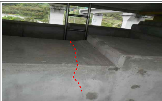
상행선 P3 코핑 상면 균열 (폭0.2mm)
