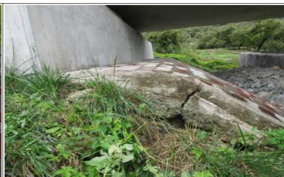
하행선 A1 법면 콘크리트 파손
