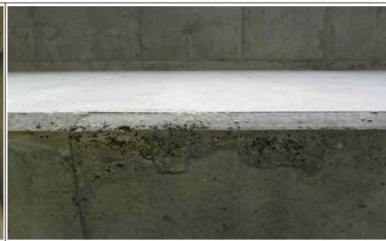
상행선 S3 주형외부 하부 슬래브 재료분리
