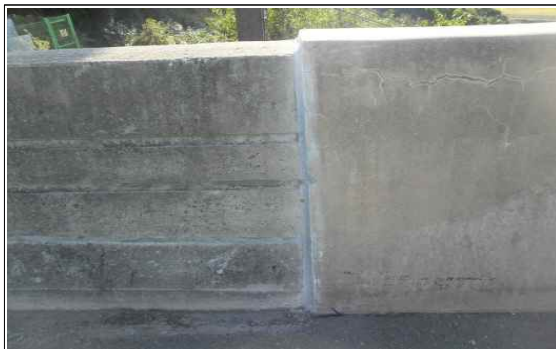
하행선 A1측 접속도로 구간 방호벽 단차발생 (약 4cm)
