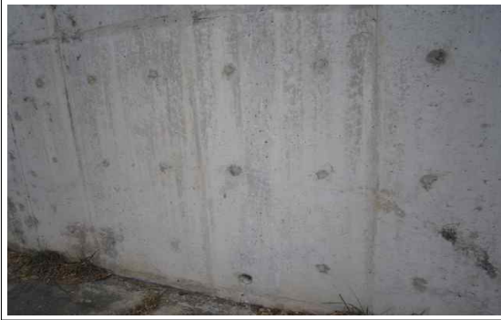
콘크리트 옹벽 S1 균열 (폭 0.1mm)
