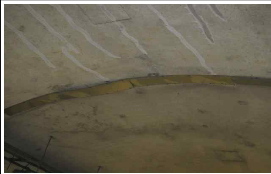
상행선 천정부 J7 조인트 덮개 탈락위험
