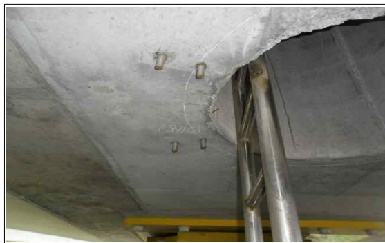
상행선 P3 점검사다리 수평지지대 탈락
