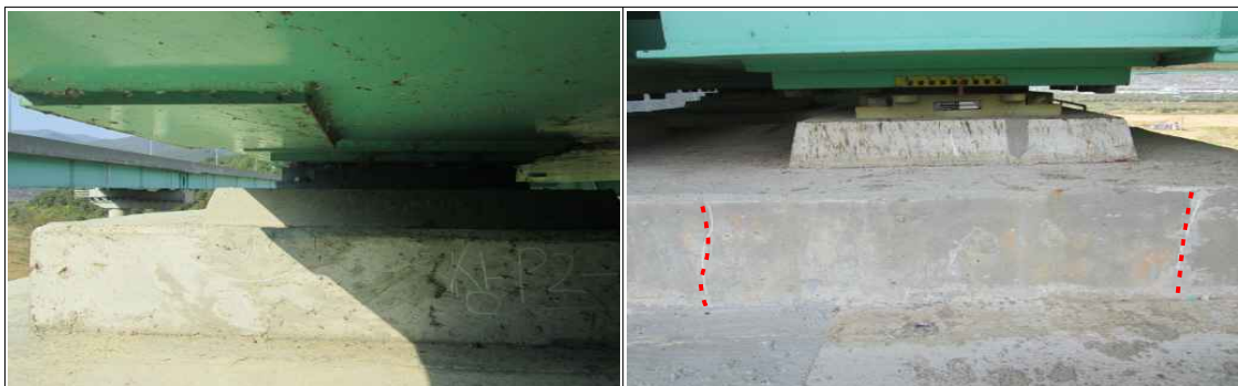
상행선 P2 SH1 받침콘크리트 보수부 재파손
