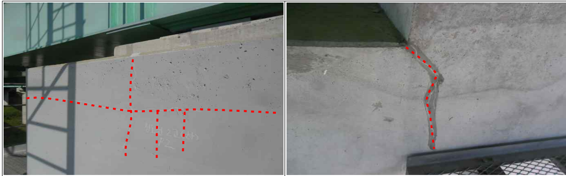
하행선 P2 코핑부 좌측면 보수부 재균열(폭 0.1mm)
