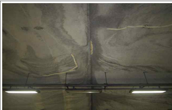
상행선 천정부 J40 콘크리트 들뜸 (A=0.1X0.2)
