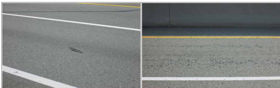
상행선 S3 교면포장 패임
