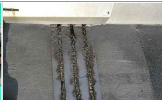
상행선 P8 신축이음 본체 녹발생 및 이물질 퇴적
