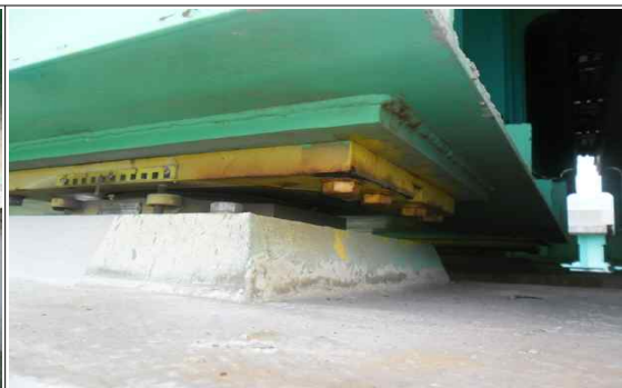
하행선 P8 SH5 Plate 도장손상 및 녹발생
