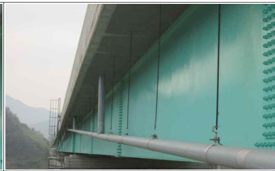
상행선 S9 배수관 연결고리 탈락
