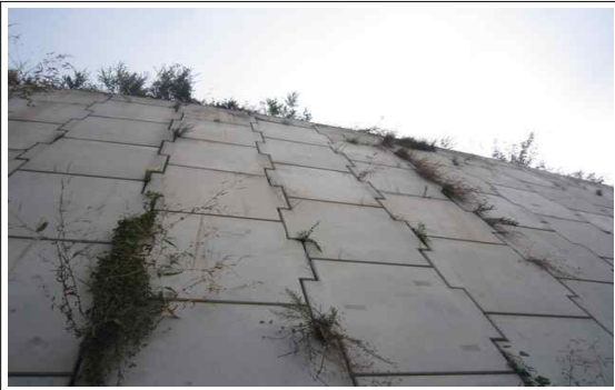
보강토 조립식 옹벽 S4 배부름
