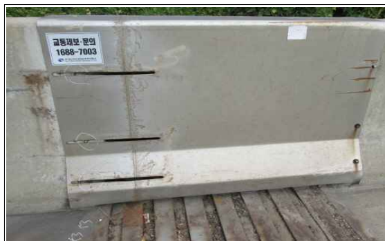
상행선 A2측 차수판 앵커볼트 탈락
