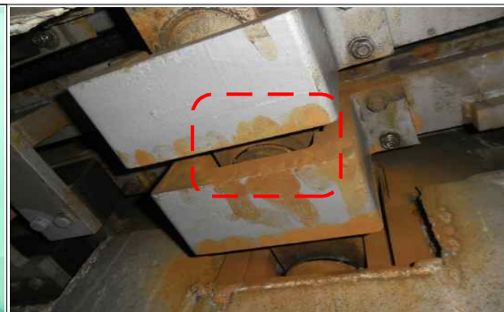
하행선 P8 신축이음 지지대 Bearing 들뜸
