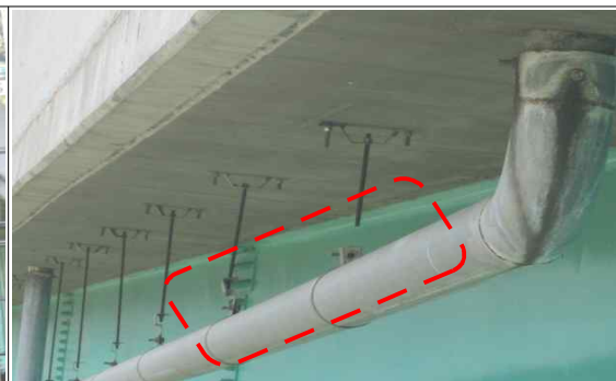
상행선 S6 배수관 연결고리 탈락
