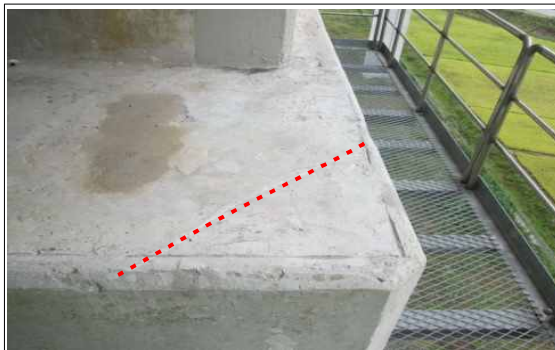
하행선 P5 코핑 상면 균열 (폭0.2mm)
