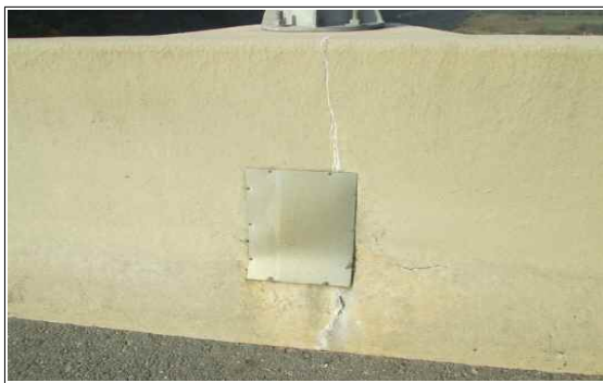
하행선 S2 방호벽 균열 및 백태
