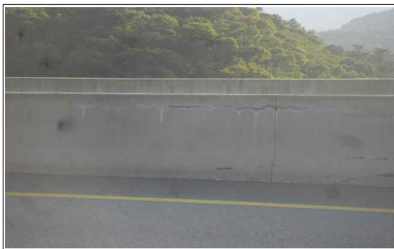
상행선 S2 방호벽 균열 (폭0.2mm)
