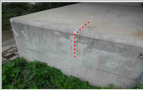
상행선 A1 우측면 균열 (폭0.2mm)
