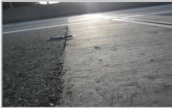
상행선 A1 신축이음 후타재 접속부 이격 및 단차
