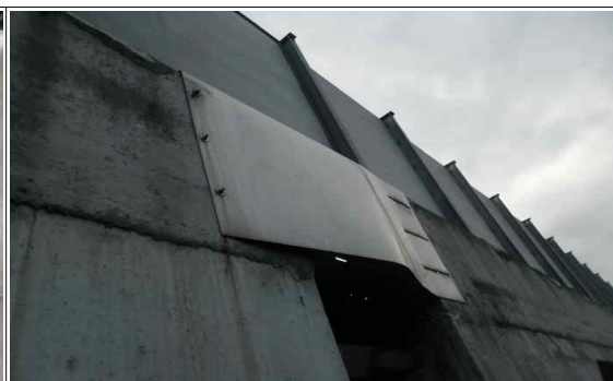
하행선 A2측 차수판 변형 및 앵커볼트 탈락
