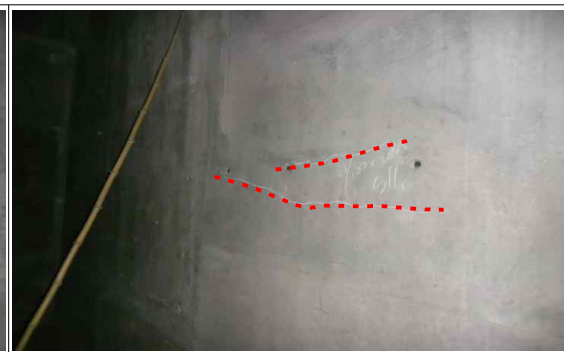
하행선 S11 주형내부 좌측면 수평 균열 (폭0.1mm)
