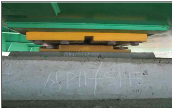
상행선 P11 SH3 받침콘크리트 균열 (폭0.1mm)
