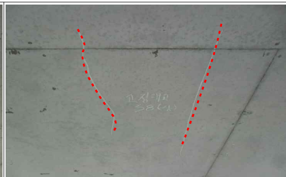
상행선 S8 주형외부 하부 슬래브 종방향 균열 (폭0.1mm)
