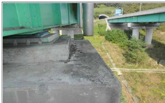
하행선 S10 (P10측) 배수관 유출구 위치 부적절 (코핑부 상부)
