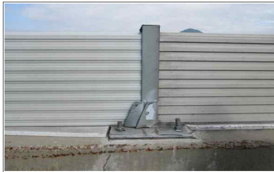
상행선 S4 방음벽 지주대 Rib 파손
