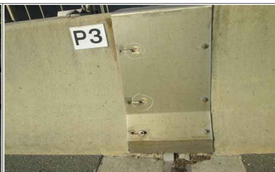
하행선 P3 신축이음부 차수판 앵커볼트 및 너트 탈락
