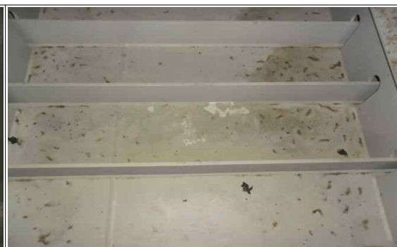
하행선 S5 G1 주형내부 도장손상 및 이물질 퇴적(곤충사체)
